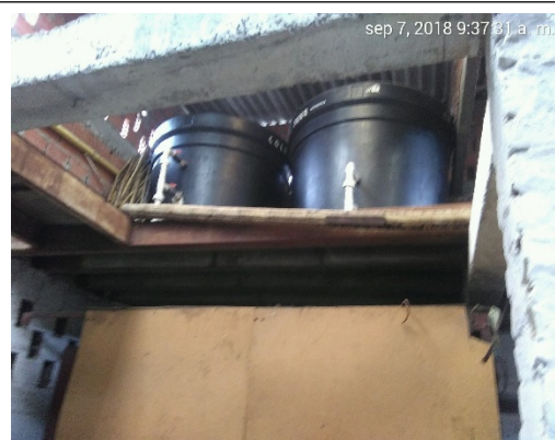
Foto No. 6 Sistema de tratamiento de ARnD.
