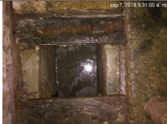
Foto No. 5 Sistema de tratamiento de ARnD.
